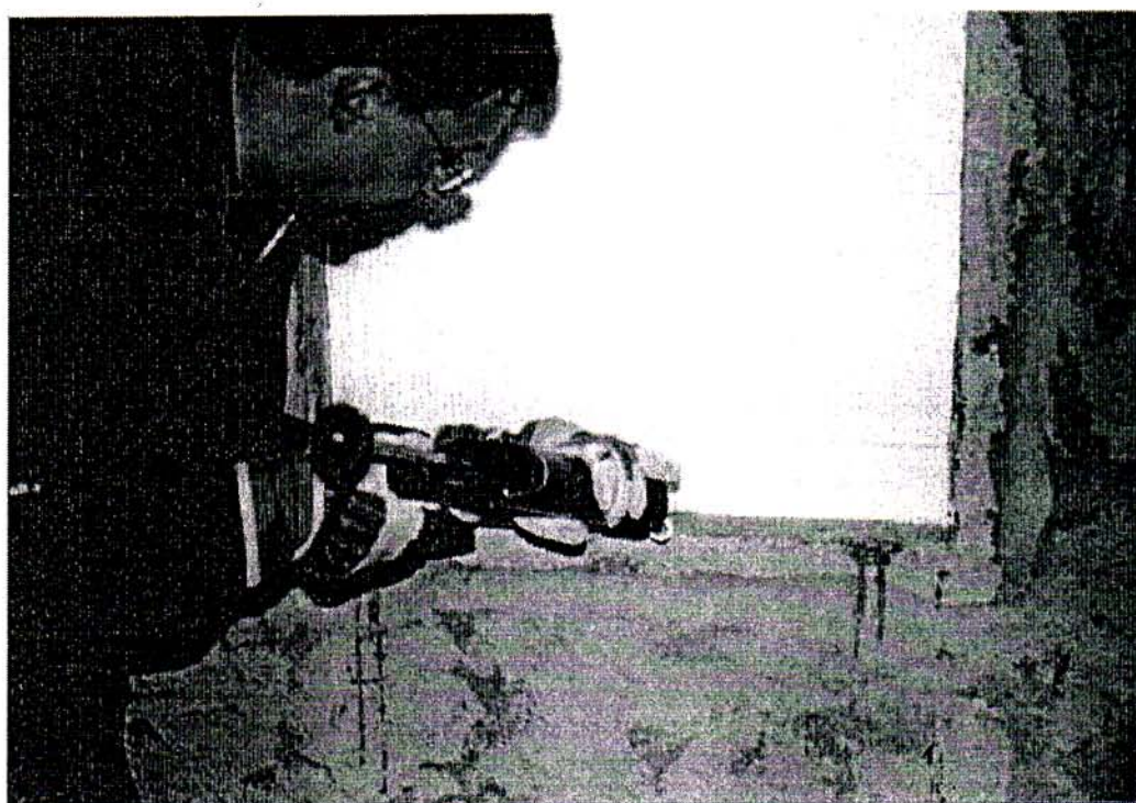
図 5: 開口部周囲をセーフティシーラントで閉塞している
